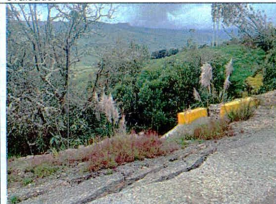
Fotografía 3. Grietas con aberturas de 20cm y longitudes de hasta 10m aproximadamente.
