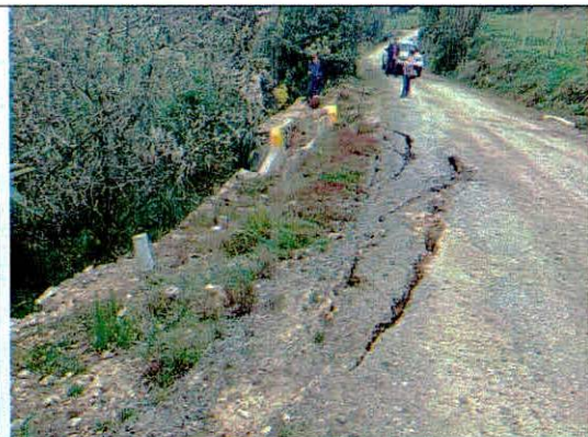
Fotografía 2. Grietas de tracción sobre la superficie del costado occidental de la vía.
