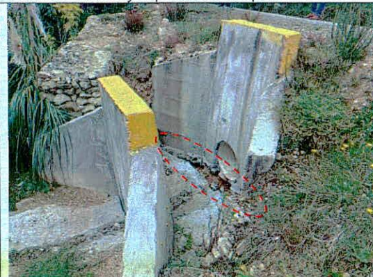
Fotografía 6. Grieta sobre el atraque de la tubería y el boxculvert en el costado occidental
