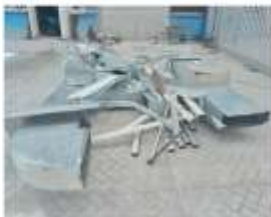
DUCTOS DE VENTILACIÓN, FLANCHES.
