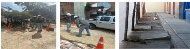
Extracción de muestras de suelo para ensayos zona plazoleta de acceso almacén Extracción de muestras de suelo para ensayos plazoleta de oxígeno. Adecuación de senderos para accesos de personal del hospital.
