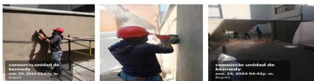
Actividades de demolición para instalación de portón de comunicación plazoleta urgencias y plazoleta unidad renal.
