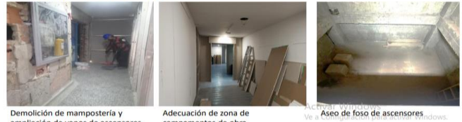
Demolición de mampostería y ampliación de vanos de ascensores. Adecuación de zona de campamentos de obra. Aseo de foso de ascensores
