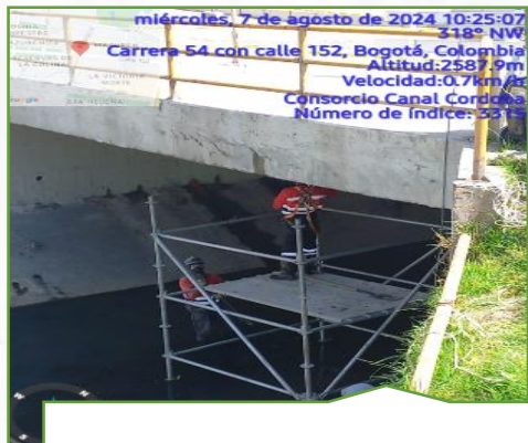
Imagen 5. Supervisión a tareas de alto riesgo (Alturas, excavaciones, izaje de cargas, espacios confinados).
