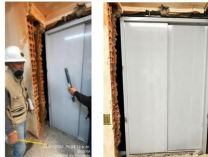
Instalación de soportes y rieles guía sección superior ascensor No. 1 y No.4
