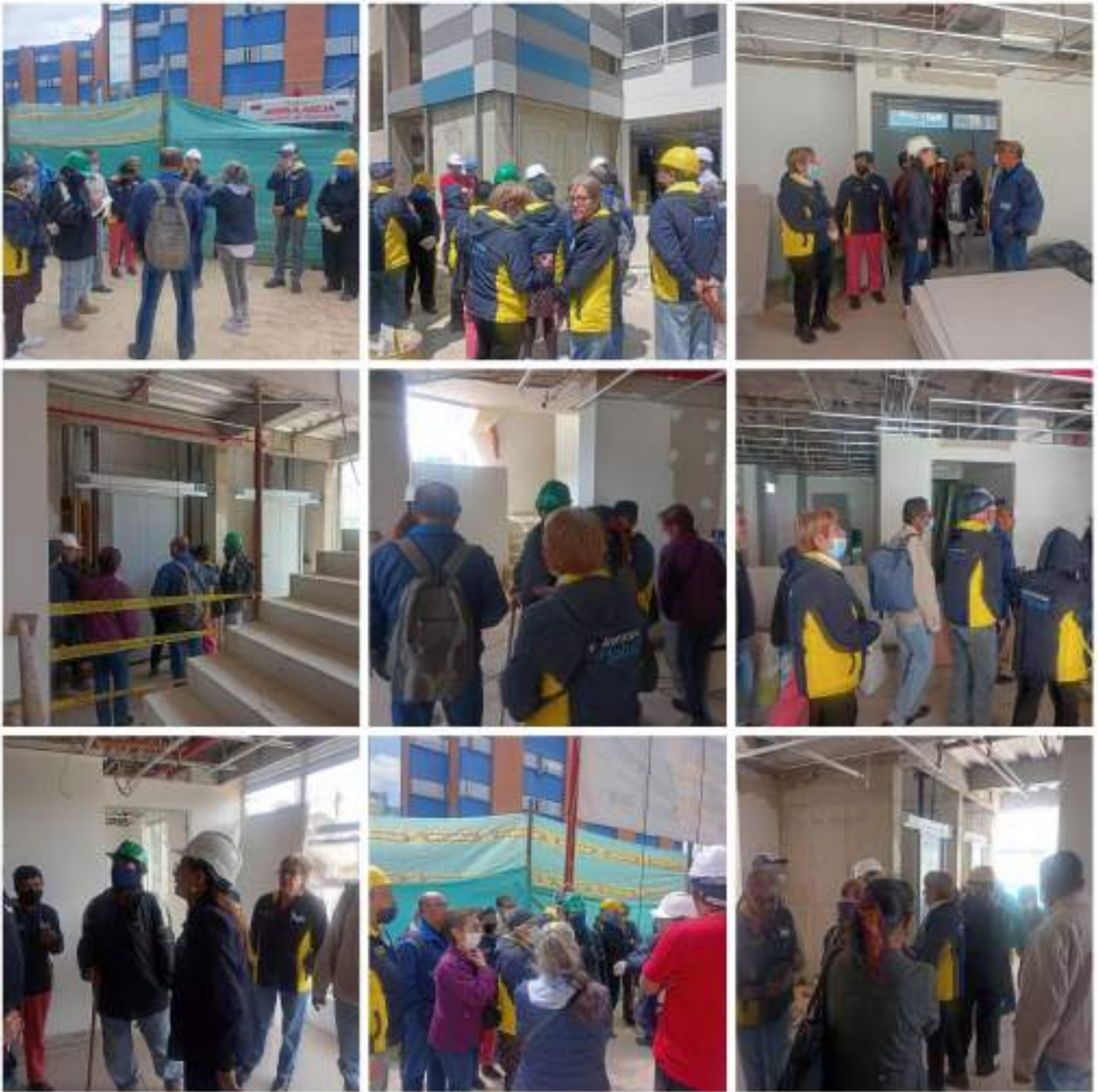
Registro fotográfico recorrido a obras de Centro de Salud Tunal – Abril 15 de 2023
