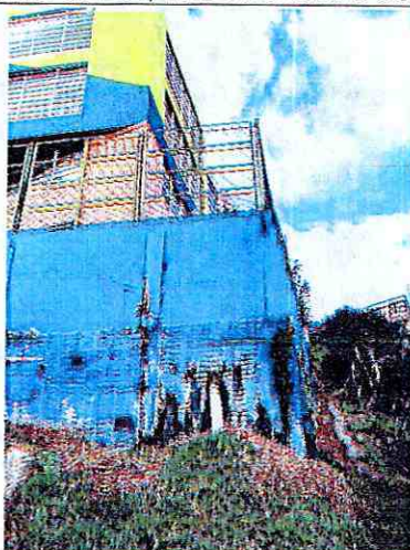
Fotografía 15. Muro Occidente en suroccidente de P1A. Tomado del DI-16446 (12/10/2021)
