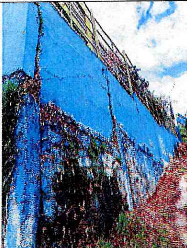
Fotografía 19. Muro Sur en suroccidente de P1A. Tomado del DI-16446 (12/10/2021)
