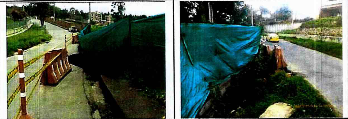
Foto No. 1. Tramo vial afectado Tv. 77 a la altura de la Calle 162 y Calle 165. Tomado de RO-48439 de abril de 2011
