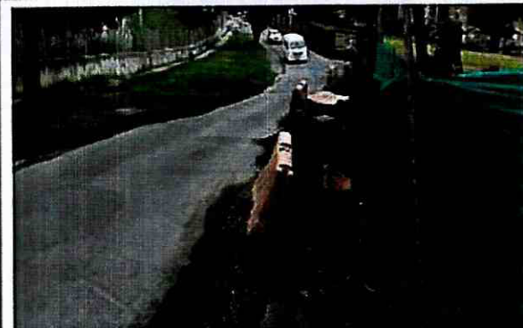
Foto No. 3. Tramo vial afectado Tv. 77 a la altura de la Calle 162 y Calle 165. Visita 147/06/2017
