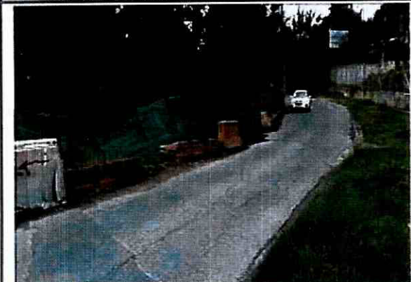
Foto No. 5. Tramo vial afectado Tv. 77 a la altura de la Calle 162 y Calle 165. Visita 147/06/2017
