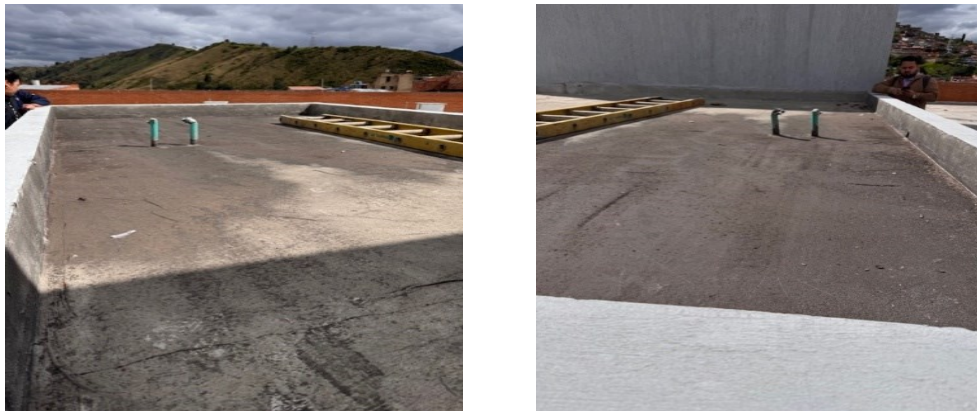
Imagen N°12, Rastro de agua acumulada
