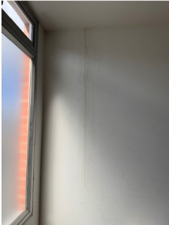
Imagen N°08, Filtraciones y humedad
