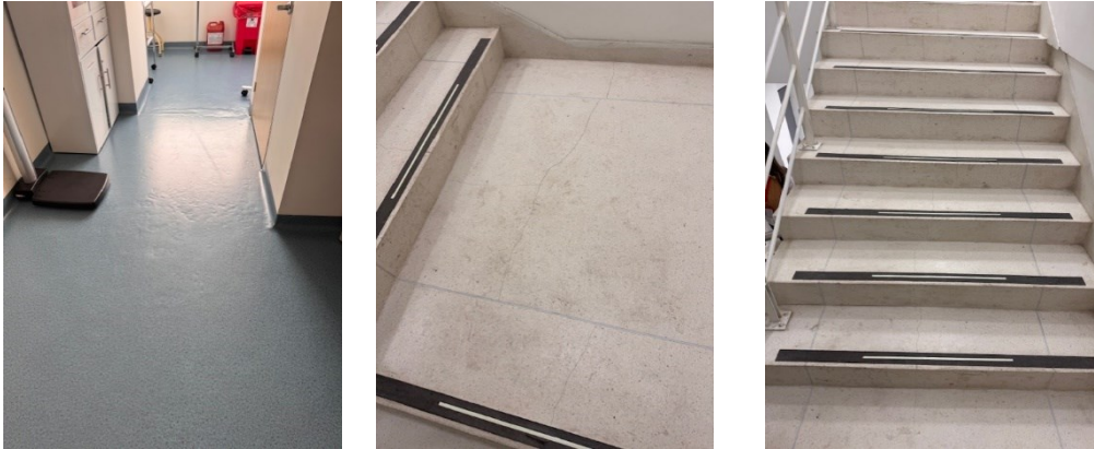
Imagen N°11, Fisuras en escaleras
