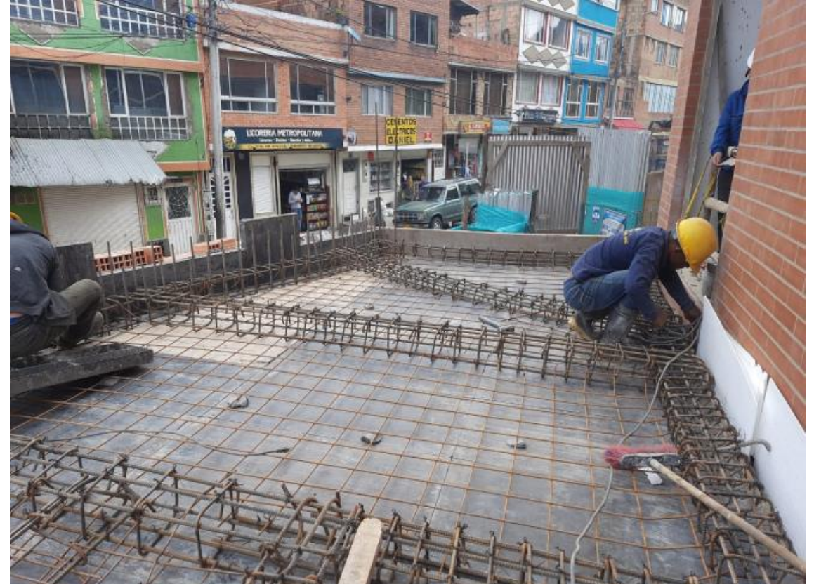
Finalización Cuarto de Maquinas
