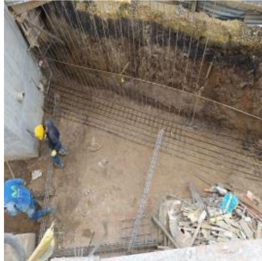
Avance Cuarto de Maquinas
