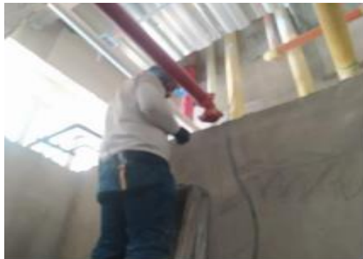
Instalación de tubería de presión y red de ventilación en área de ductos
