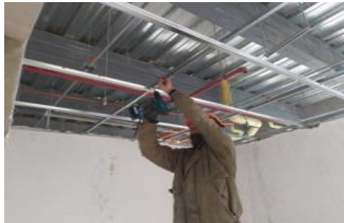
Instalación de estructura para la instalación del cielo raso falso en área de recepción Urgencias piso 1
