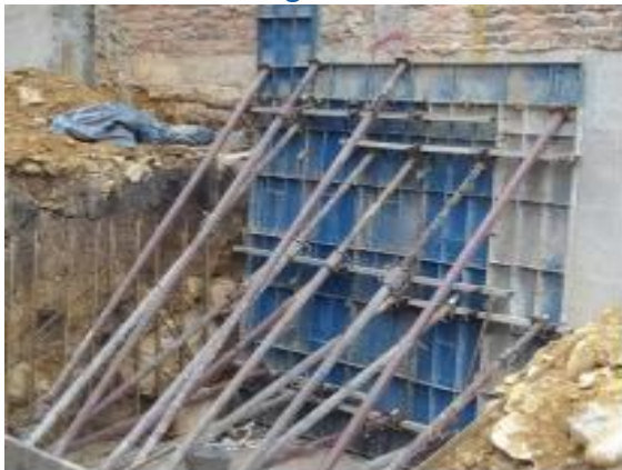
Instalación de Testeros y formateado de muros trincheras previo fundido del elemento
