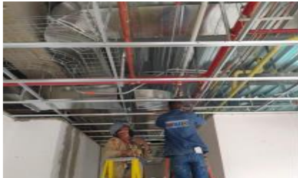
Instalación de RCI
