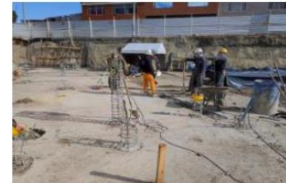
Localización y trazado de vigas de cimentación para iniciar actividades de excavación manual Torre 2.
