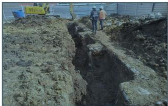
En las actividades de excavación se encuentra cimentación existente.
