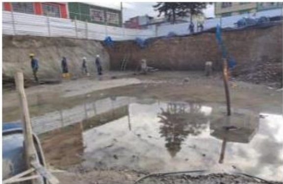
Lluvias afectando fondo de excavación
