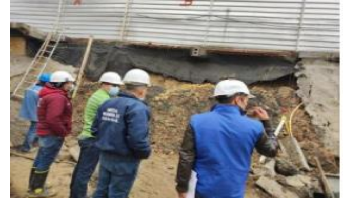
Deslizamiento talud costado carrera 26 debido a las fuertes lluvias.
