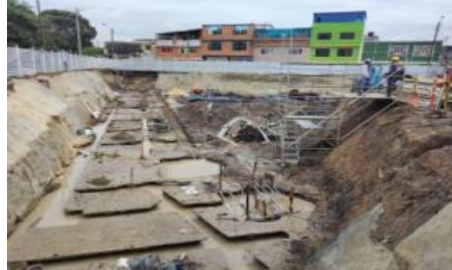
Estado del fondo de excavación después de fuertes lluvias.
