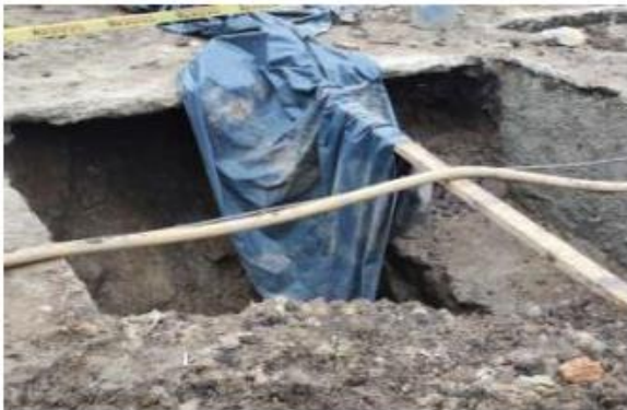
Carcavamiento por lluvias
