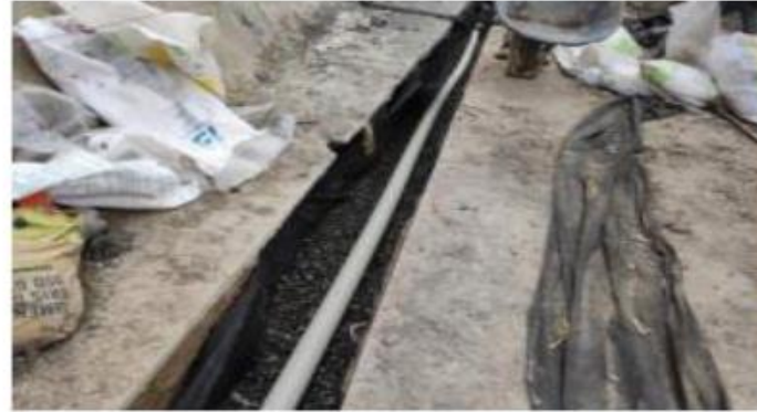
Continuación de actividades de excavación manual vigas de cimentación Torre 2 y descabece de pilotes
