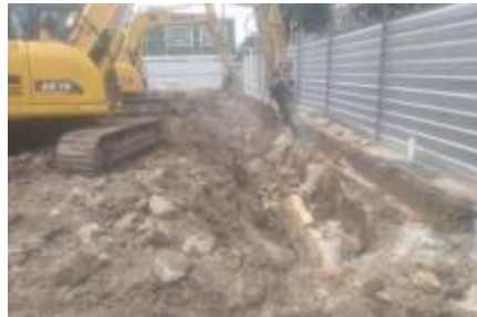
Cimentación de volumen considerable de la antigua edificación la cual se esta demoliendo mecánicamente.
