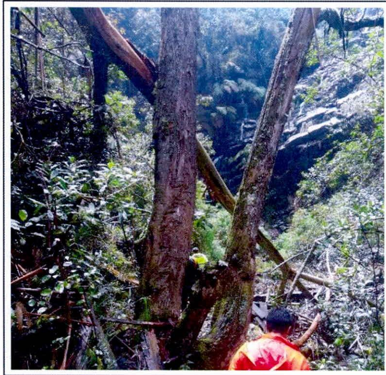
Fotografía 8 Rama caída la cual generó el colapso del puente de la cascada.
